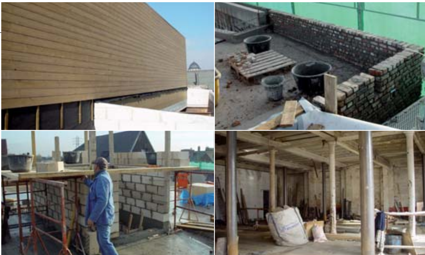
Enkele gebruikte materialen: thermisch behandeld hout voor de zijgevel, oude bakstenen voor nieuw metselwerk, cellenbeton op de bovenbouw. We dienden enkele nieuwe stalen zuilen te plaatsen naast de originele. (Foto's: Jenny Dedoncker)
